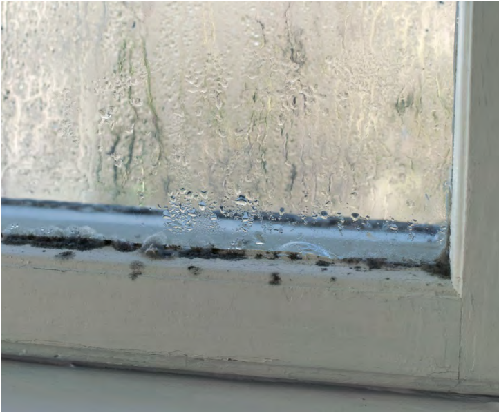
Abbildung 17: Kondensat auf Verglasung, vorzugsweise unten
