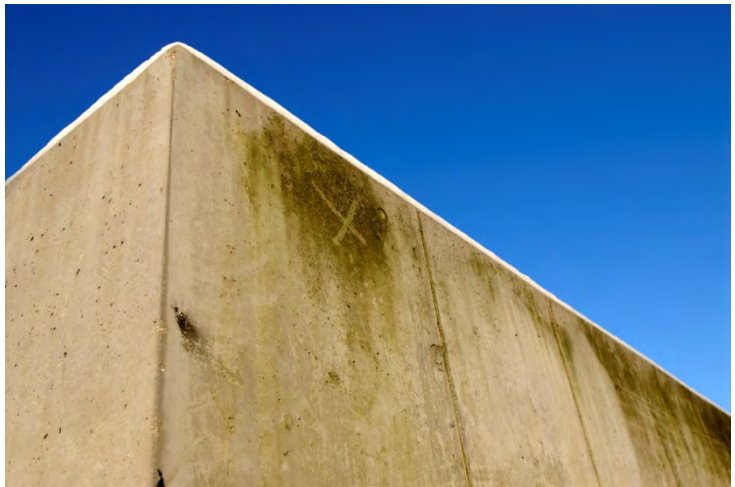
Abbildung 26: Algen auf einer Fassade
