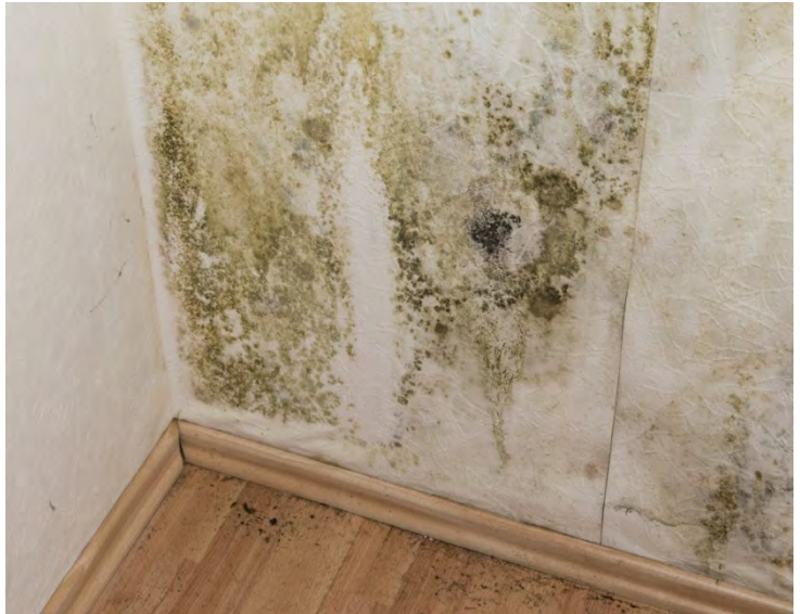
Abbildung 25: Schimmel in einer Außenecke (vor allem hinter Kästen)
