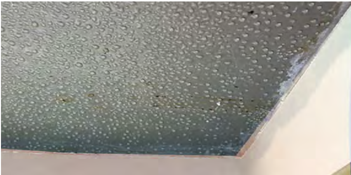
Abbildung 16: Kondensat auf nicht saugender Decke
